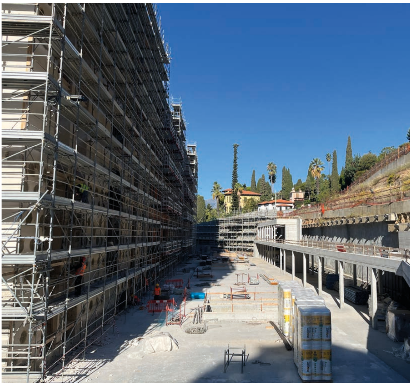
GSKD EDILE S.P.A - Impianti Tecnologici Residenza Angst, Bordighera
