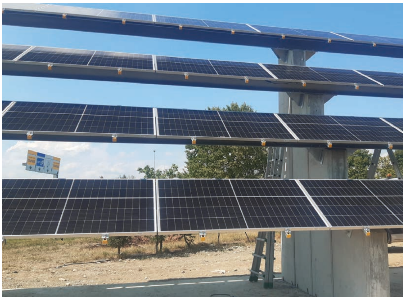
S.A.T.A.P S.P.A. - Impianto Fotovoltaico, Biandrate
