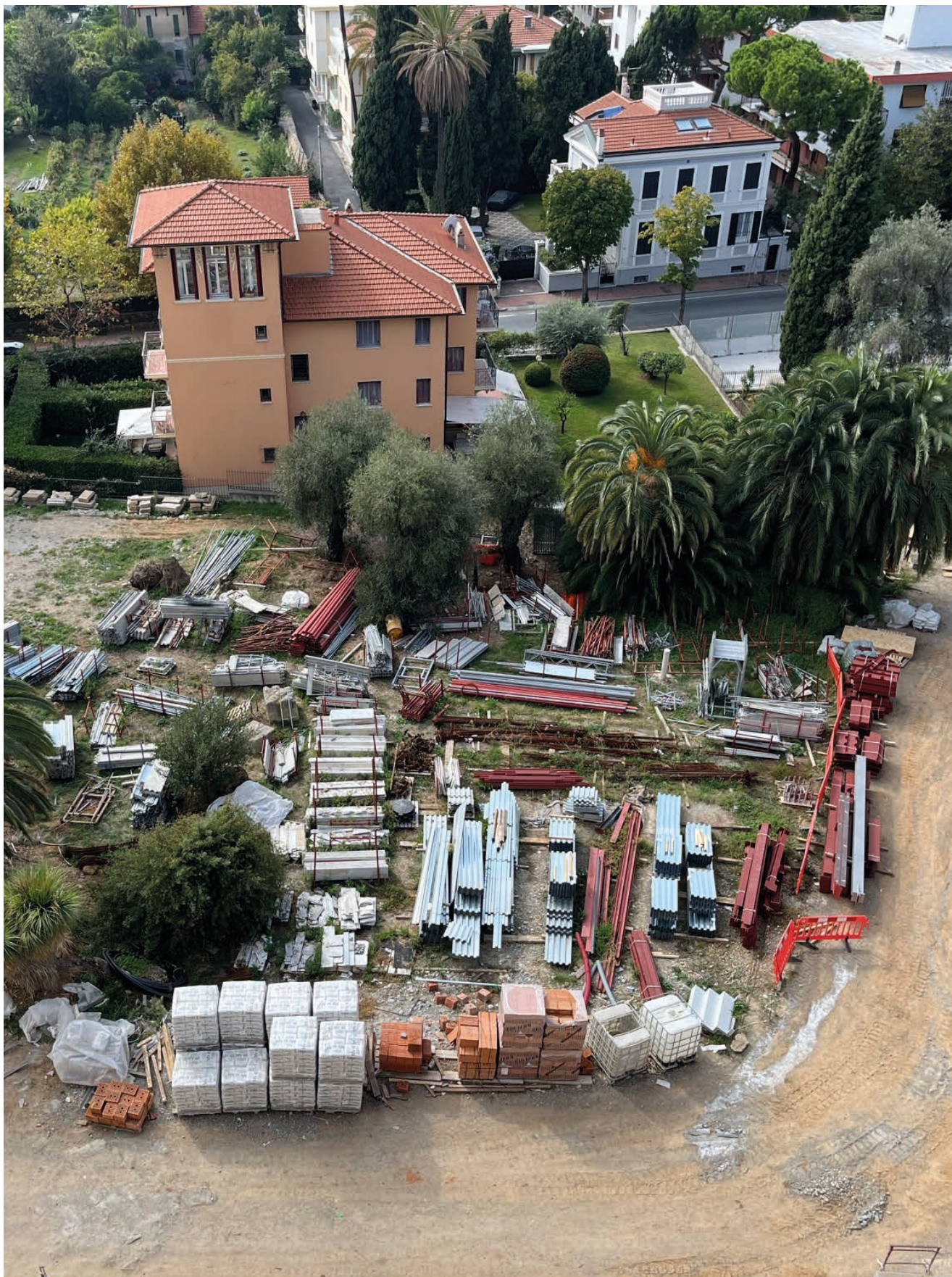
GSKD EDILE S.P.A - Impianti Tecnologici Residenza Angst, Bordighera
